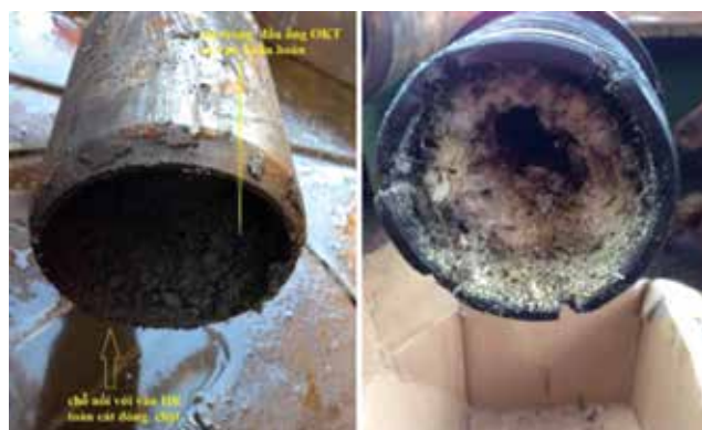
Hình 9. Sa lắng muối kết hợp cát trong ống khai thác giếng Thỏ Trắng.
